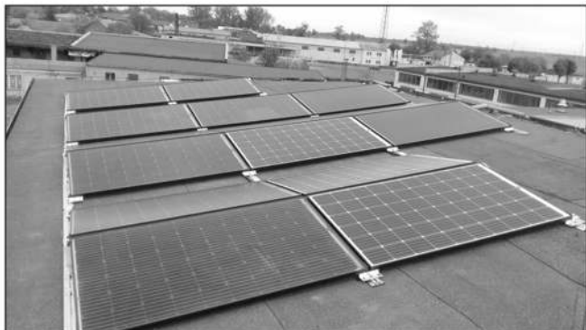
fot. Zainstalowane panele fotowoltaiczne na budynku Centrum Rozwoju Gminy Pępowo.
