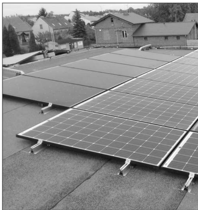
fot. Zainstalowane panele fotowoltaiczne na budynku Centrum Rozwoju Gminy Pępowo.
